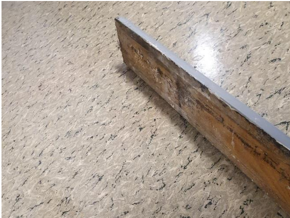
Foto 3. I toalettområdet ved klasserom 7 er det rik vekst av muggsopp på baksiden av gulvlist, både under håndvask og ved utgangsdør.
