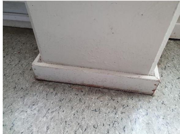
Foto 4. I klasserom 5 er det tettet mellom gulvlist og betongsøyler.
