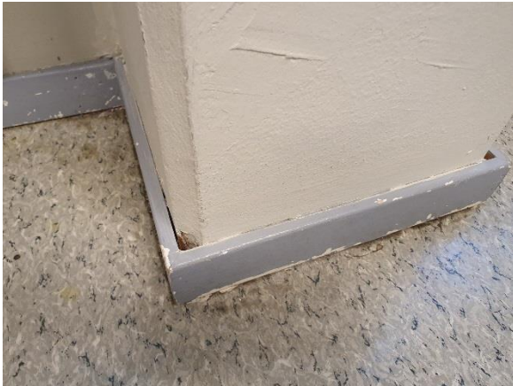
Foto 1. I klasserom 7 og 9 er det glipper mellom gulvlist og betongsøyler. Test med røykblåse gir en klar indikasjon på et lufttrekk opp fra glippene. Det virker dessuten som om den muggsopp-/jordaktige lukta er spesielt sterk ned mot glippene.
