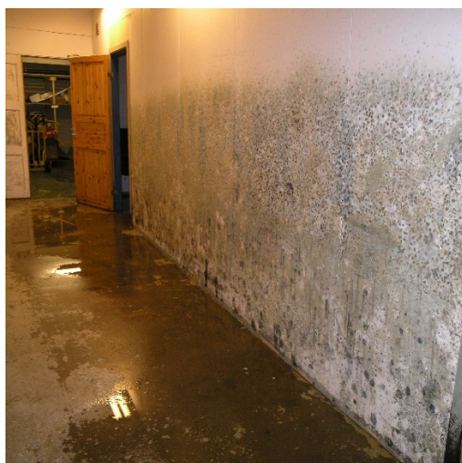
Muggsoppvekst som følge av vannskade.
